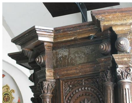
Figur 7.4.50. Bavelse Kirke. Skader fra ætsning ses som udsvedning af krystallinsk agtige salte. Det ætsede træværk bærer en samtidig tonet overfladebehandling. Bavelse Kirke, Tybjerg herred, Præstø amt.
