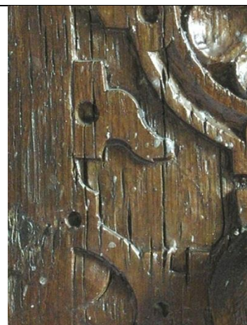
Figur 7.4.49. Søby Kirke. Detalje af svindskader i altertavlens træværk forårsaget af ætsning udført i 1850. Søby Kirke, Baarse herred, Odense amt.
